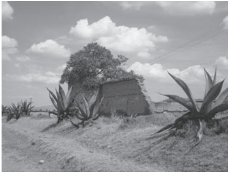
Figura 13. Estado de conservación de muros de tapia con adobe. Imagen de autor.
