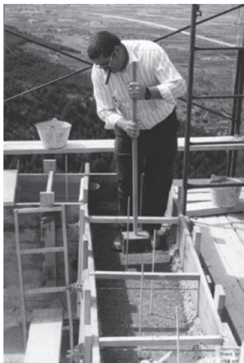
Figura 2. Restitución de tapial calicostrado, armado, para unirlo al resto de la fábrica.
