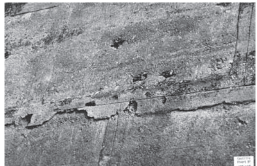
Figura 6. Desprendimiento de juntas en sillares fingidos.
