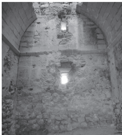
Figura 6. Vista interior de la Torre. Se aprecia el deterioro del acabado interior de los muros y el desprendimiento parcial de la bóveda de cañón.
