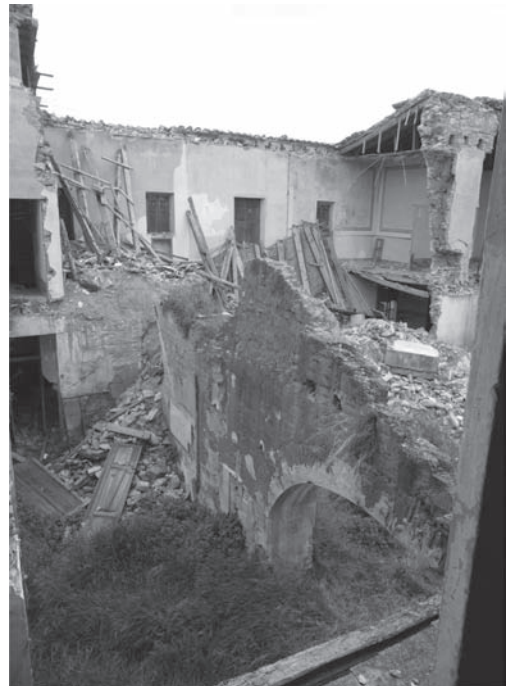
Figure 2. Collapsed tapia valenciana walls in a 16th century building (“El Relpá” in Alquerías del Niño Perdido, Castellón).
