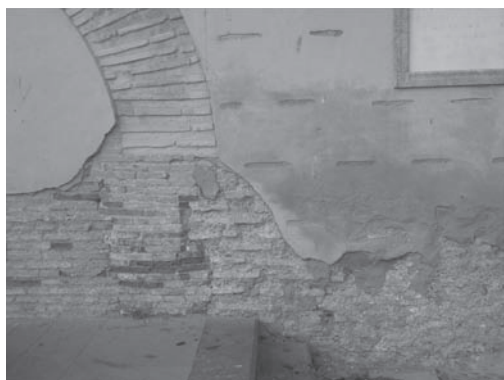
Figura 6. Sede Gremio de Carpinteros de Valencia. Deficiente restauración de la tapia. Humedades de capilaridad por falta de puntido, desconchones en el enlucido y anárquica distribución de las hiladas.
