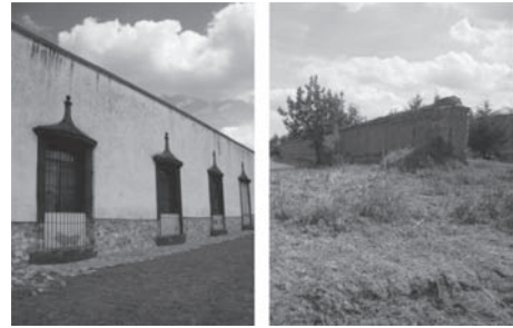
Figura 15. Distintos estados de conservación en muros de tapia de la hacienda Santa Teresa Ixtafiyuca. Imagen de autor.
