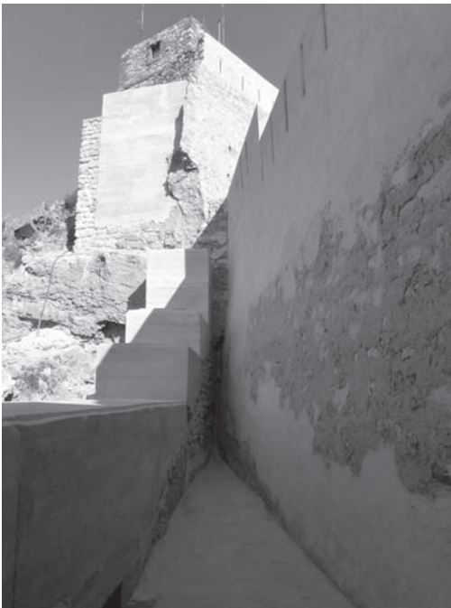
Figure 6. Alzados exteriores del sector 2. Consolidación de los restos del trazado exterior de la muralla medieval de castillo.
