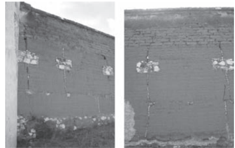
Figura 12. Estado de conservación de muros de tapia con cerramiento de adobe. Imágenes de autor.
