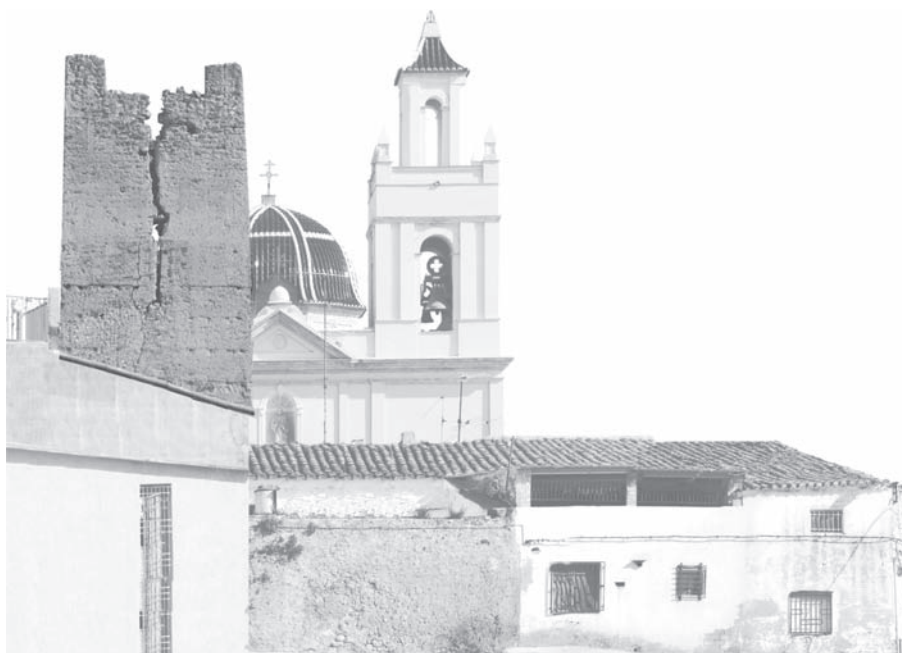
Figura 4. Alzado sur. Vista de la torre en su entorno. En esta fachada se aprecia su deteriorado estado actual con enormes grietas y pérdida de material. (Autor: realización propia).
