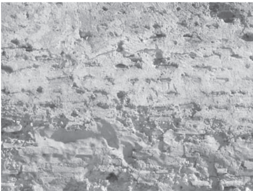
Figure 1. Unrestored tapia valenciana wall (San Miguel de los Reyes, Valencia).
