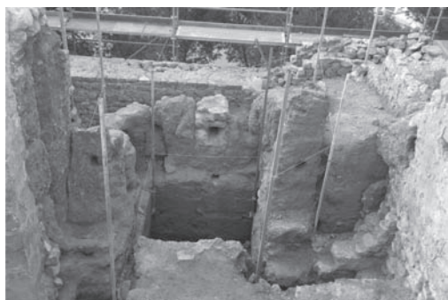
Figura 4. Interior de la torre. Se aprecia el elevado grado de deterioro de las tres últimas hiladas.
