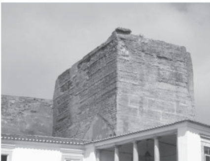
Figura 1. Reparaciones de 1995 en la torre de tapia militar. Castillo de Moura. Imagen de 2003.
