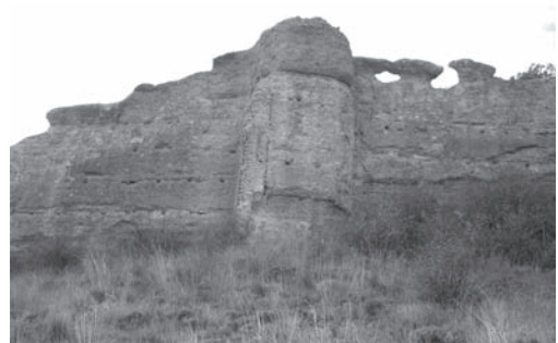
Figura 2. Tramo de muralla erosionado.
