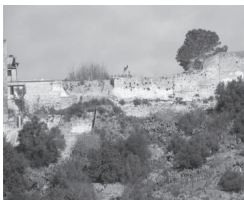
Figura 5. Tramo S4 de las murallas del patio de armas antes de la intervención.
